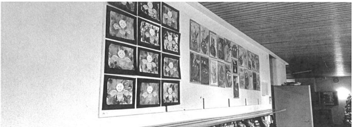
abgenutzte und defekte Pinnwände im Riedli
